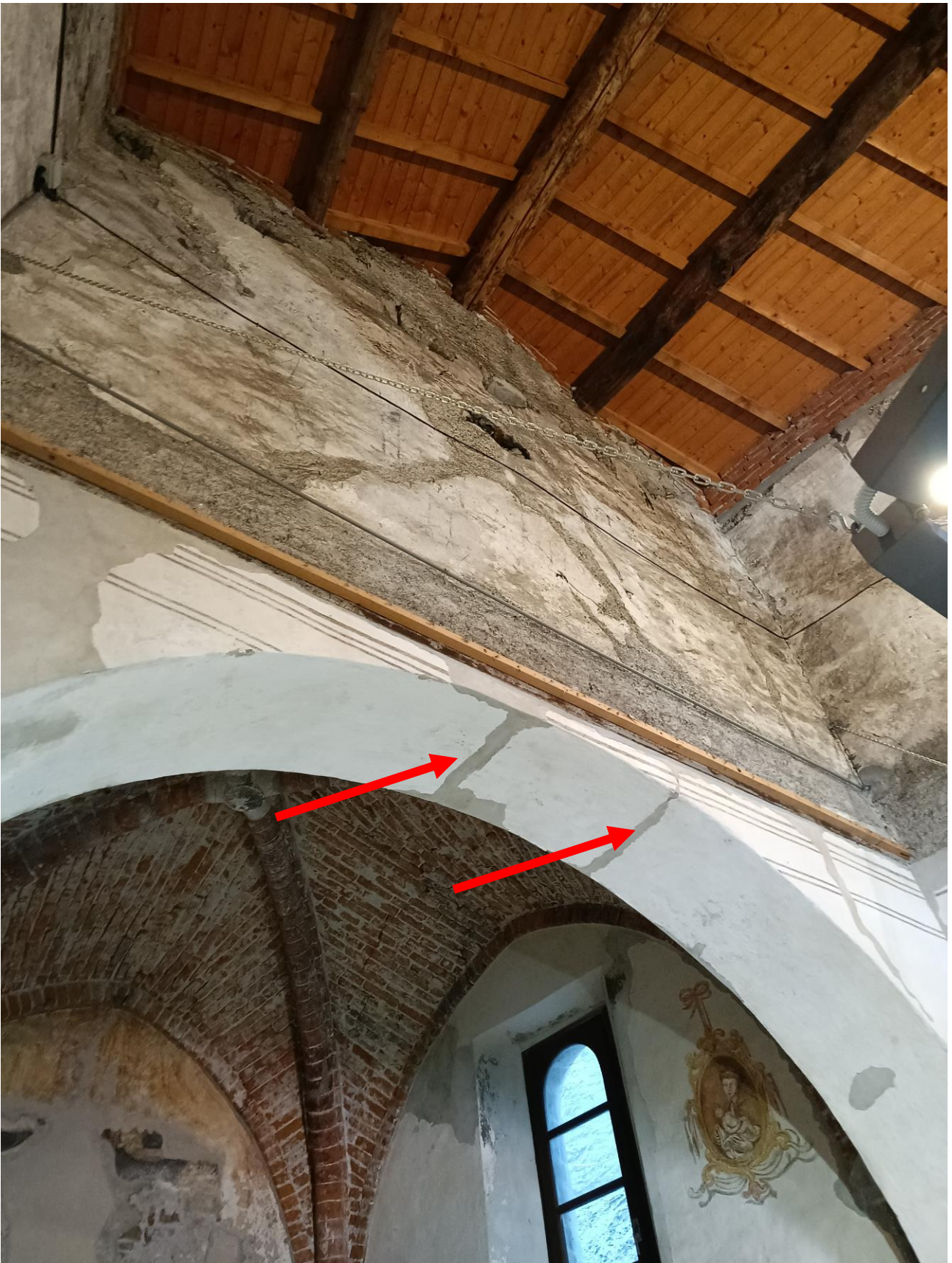
Quadro fessurativo arco – si rilevano fessure precedentemente stuccate
